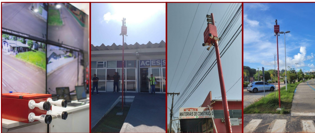
Equipamentos já instalados em várias cidades
