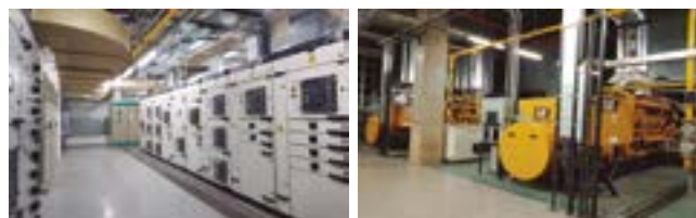
Figuras 10 e 11: USINA DE ENERGIA. Hospital Sírio Libanês - 34,5 KV; (9MVA de gerador instalado e mais de 100% de redundância) - Bi combustível (GN e Diesel).
