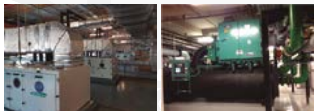
Figuras 12 e 13: Casa de Máquinas de Ar Condicionado Hospital Sírio Libanês de SP e Central de Água Gelada - 3000 TR.
